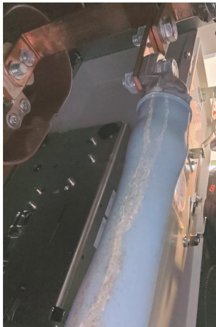
kondensacja powietrza powoduje ściekanie wilgoci
