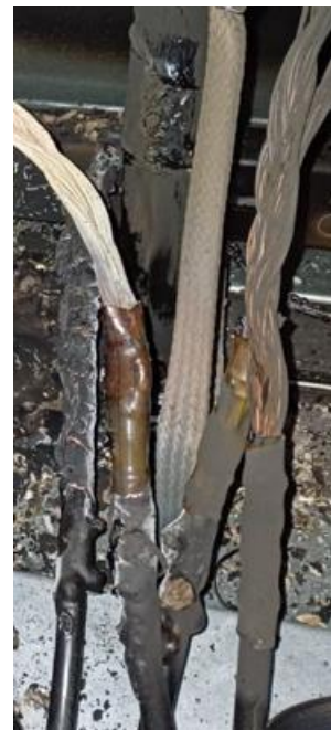
nieprawidłowe połączenie uziemienia
